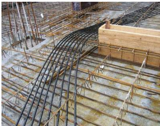
Câbles de précontrainte par post-tension mis en œuvre dans une dalle Immeuble IEK-D à Kirchberg (L)
