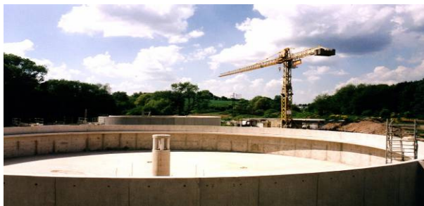
Station d'épuration à Saint-Avold (F)
